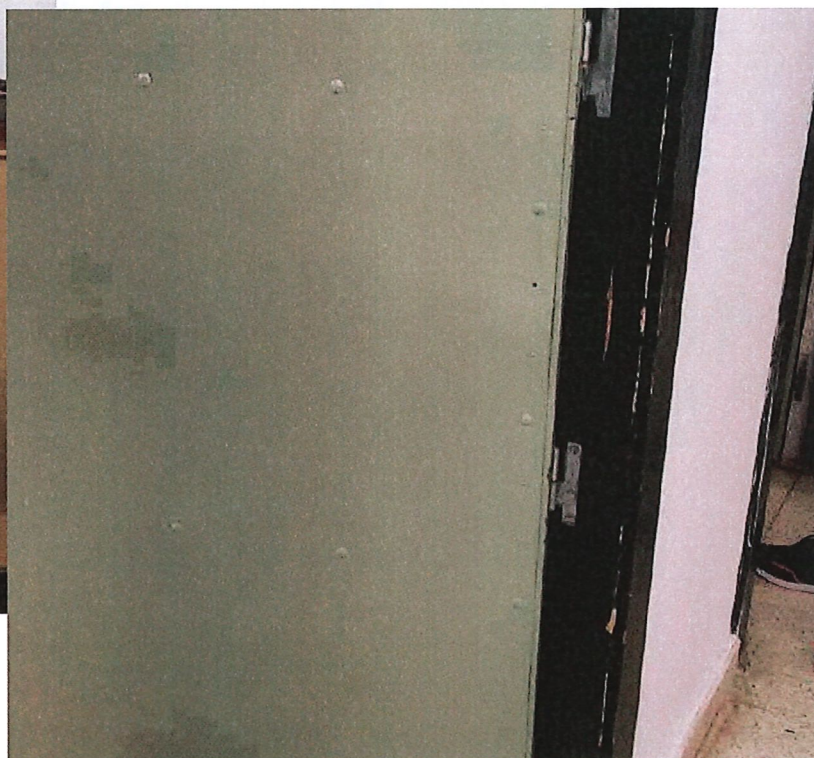
Falta de manteniment de les fusteries en general
